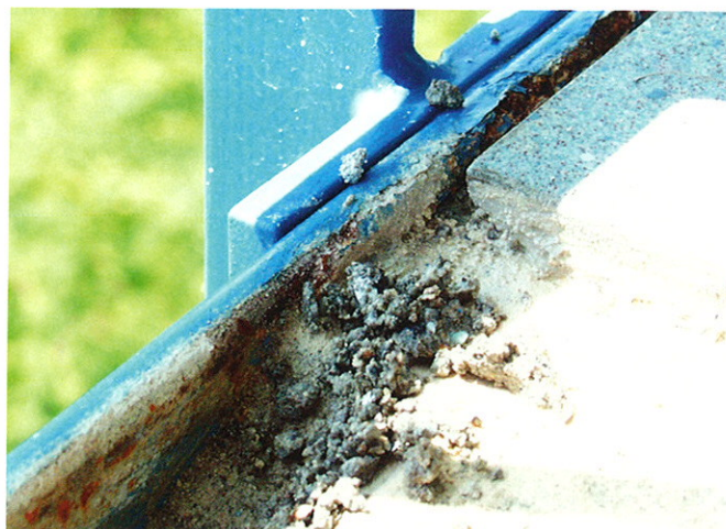
Abb 4: Sondierstelle gemäss Schaden auf Abb. 3
