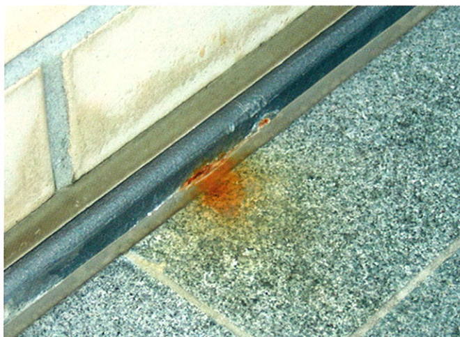
Abb 9: Ein typisches Schadensbild beim Anschluss des Balkons gegen die Aussenwand
