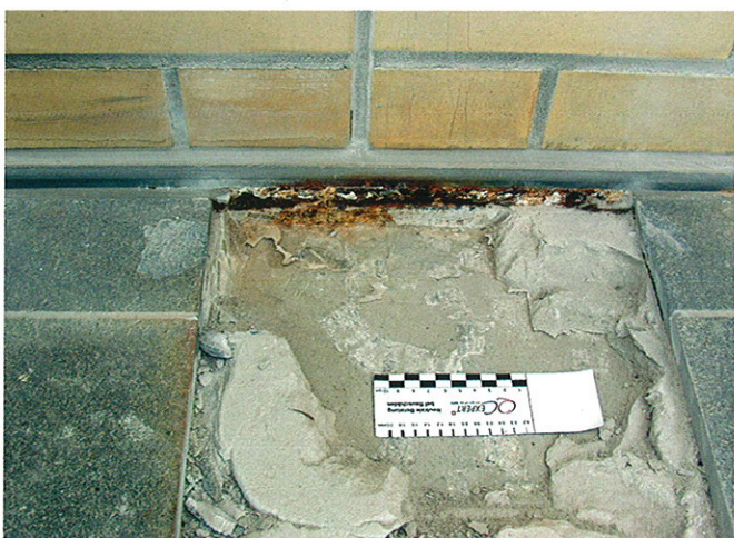
Abb 11: Vorgefundene Situation an der Sondierstelle: Aussenwandanschluss
