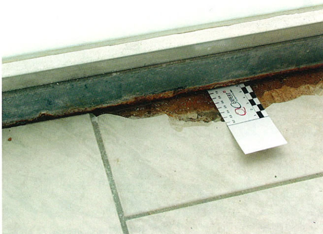
Abb 7: Schaden zum Zeitpunkt des Beweissicherungsverfahrens
