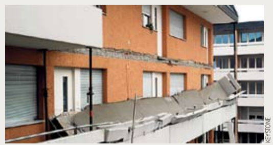
Eingestürzter Laubengang in Uster ZH: Mehrere hunderttausend Franken Schaden.
